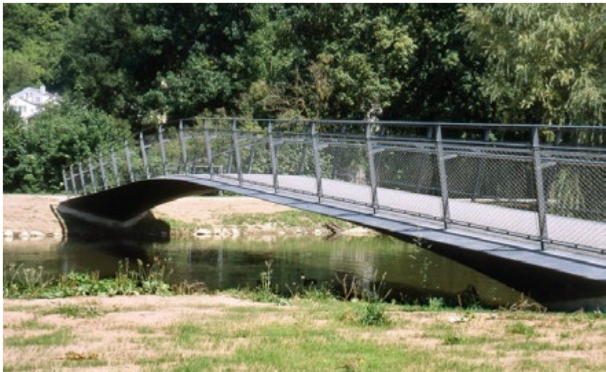
Beispiel für Geh- und Radbrücke im Hochwasser | Architektur, Bildquelle: Christian Vogel
